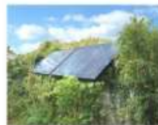
Les capteurs thermiques sont adossés à un mur de pierre. Cette solution demande une surveillance de la croissance de la végétation pour éviter toute ombre portée. Vigy (Val d'Oise) © PMR du Jardin Français
